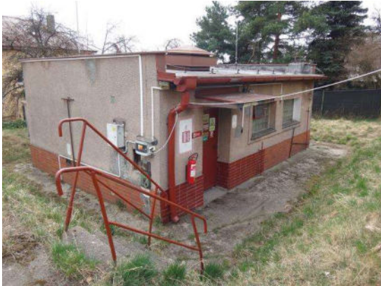
plynová regulační stanice
